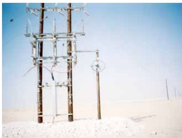
A 70 kilometre OPGW line in Rumaitha.
